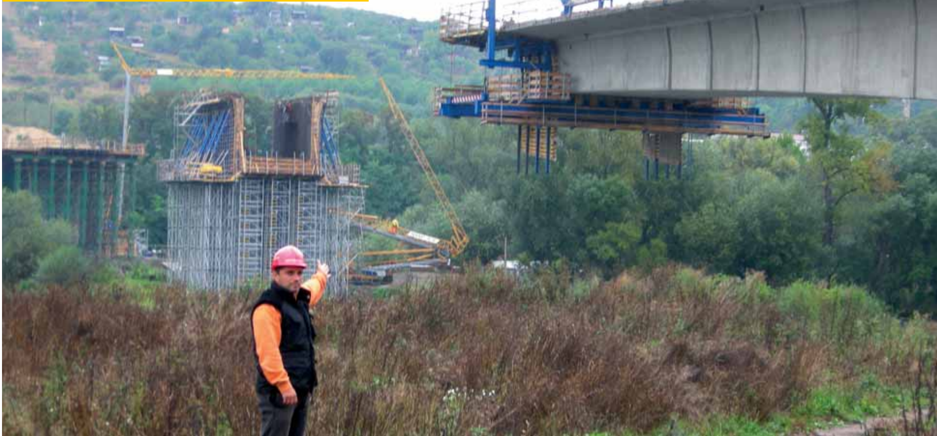
Hlavní stavbyvedoucí Jan Růžička z Metrostavu ukazuje na nově budovaný šestý pilíř mostu přes Labe od Mlékojed přes Písečný ostrov k Žalhosticím.
