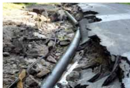
Srpnové povodně napáchaly v regionu SVS škody na vodovodních sítích, které je nutné urychleně rekonstruovat, aby bylo zajištěno bezproblémové zásobování obyvatel pitnou vodou.
