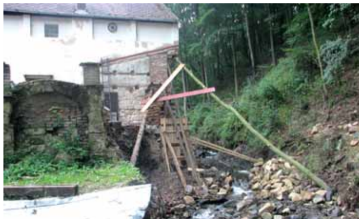
Škody na obecním majetku Těchlovic, na komunikacích a mostcích, určitě překročí 20 milionů korun.
