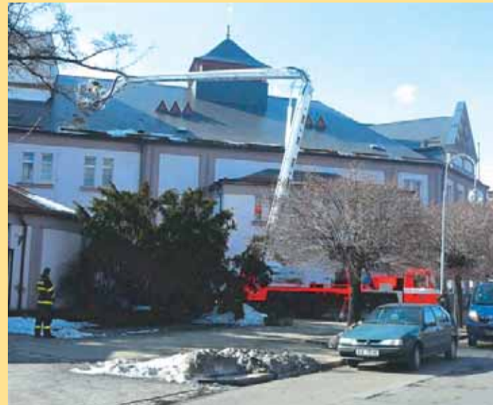
Zřícený komín na střeše městského divadla pomáhali odstranit hasiči.
