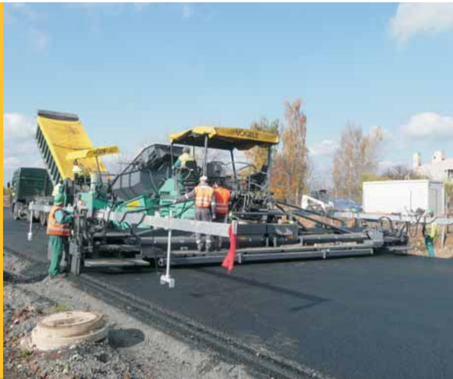
Bezspárová pokládka finišerem s pevnou lištou a plnicím vozem zásobovaným z vysokokapacitní obalovny
