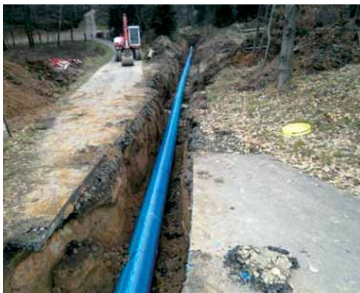
V oblasti obnovy majetku byla provedena důležitá rekonstrukce části vodovodního přivaděče v Liberci – Vesci, Šumné ulici. V případě poruchy zásobování vodou z úpravy vody Bedřichov se jedná o náhradní trasu pro zásobování vodou krajského města Liberec. Spolehlivost a funkčnost tohoto vodovodního řádu je nutností pro přípravu plánované rekonstrukce úpravy vody Bedřichov.
