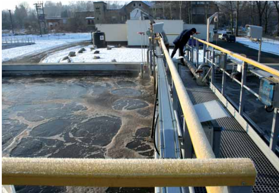
Letos v únoru dokončila SVS v Ústeckém kraji strategickou investici v oblasti čištění odpadních vod – rekonstrukci ČOV Šluknov. Po rekonstrukci má ČOV dvojnásobnou kapacitu 7 000 ekvivalentních obyvatel, což umožní rozvoj aglomerace včetně připojení plánované průmyslové zóny.
