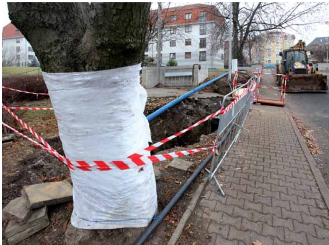
V Mostě byla v rámci obnovy infrastrukturního majetku dokončena bezvýkopovou metodou rekonstrukce vodovodu v ulici Mikoláše Alše. Realizace stavby byla náročná v tom, že řad je vedený pod vzrostlými stromy.
