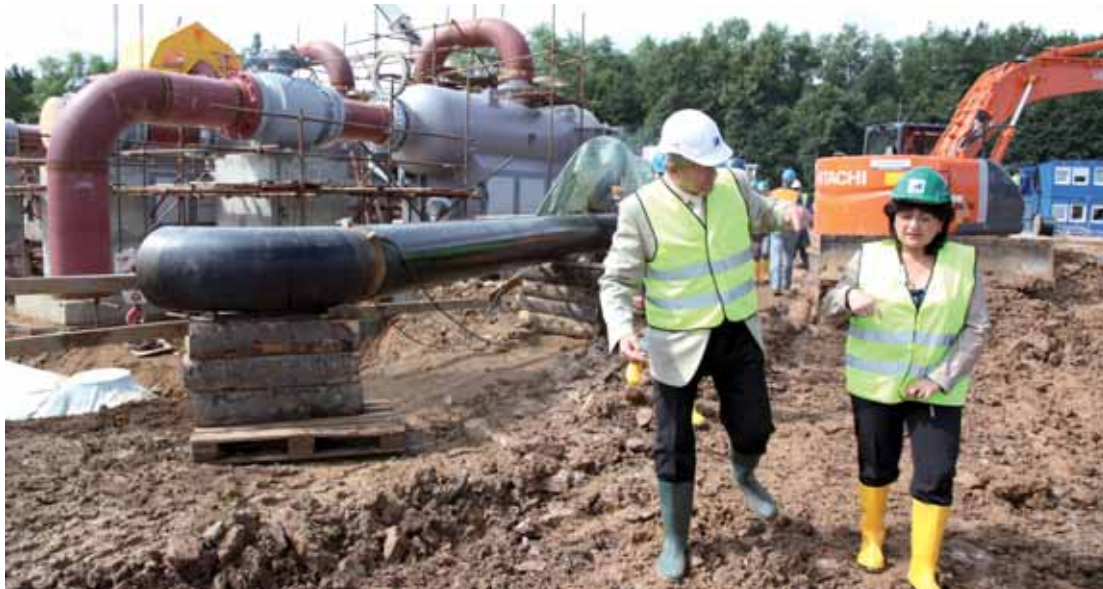
Hejtmanka Jana Vaňhová si v doprovodu jednatele společnosti NET4GAS Jana Nehody a dalších odborníků z dodavatelů plynovodu prohlédla staveniště stanice v Brandově.
